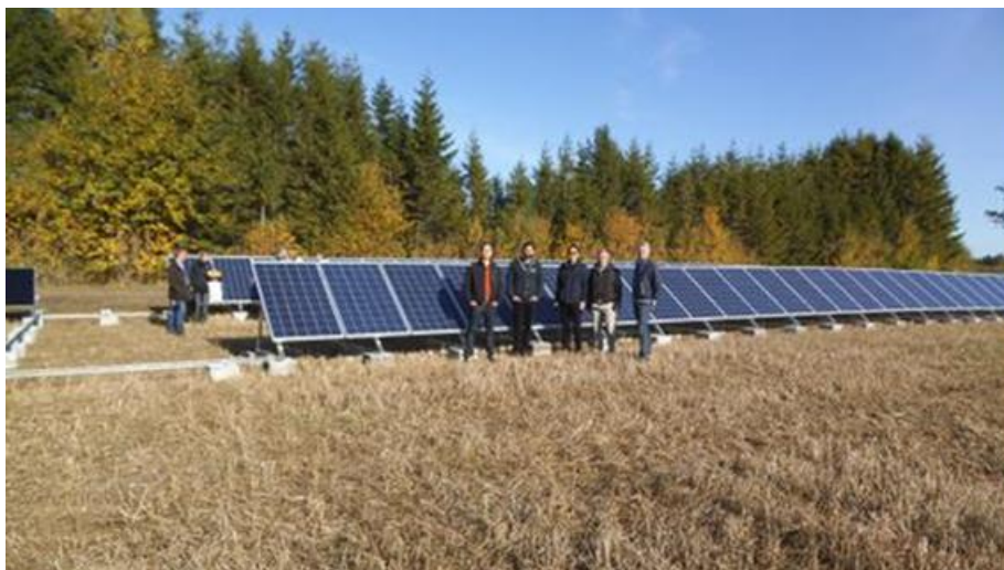
Figur 4: En av två solcellsanläggningar som är anslutna mot samma lågspänningskrets i testområdet mellan Källunge och Bäcks.
